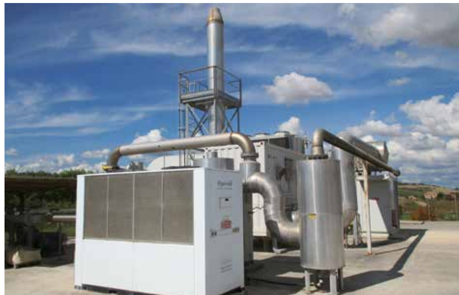
Un impianto di Semia green per la valorizzazione del biogas da discarica
